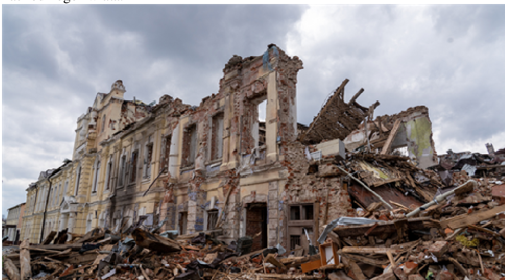
Zniszczony budynek mieszkalny po rosyjskim ataku w Charkowie
